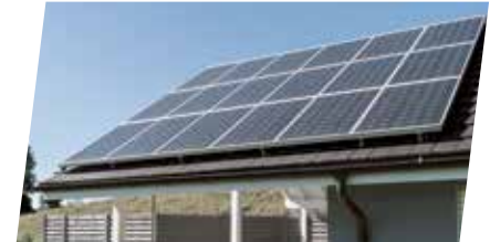
Solaranlage auf einem Flachdach
